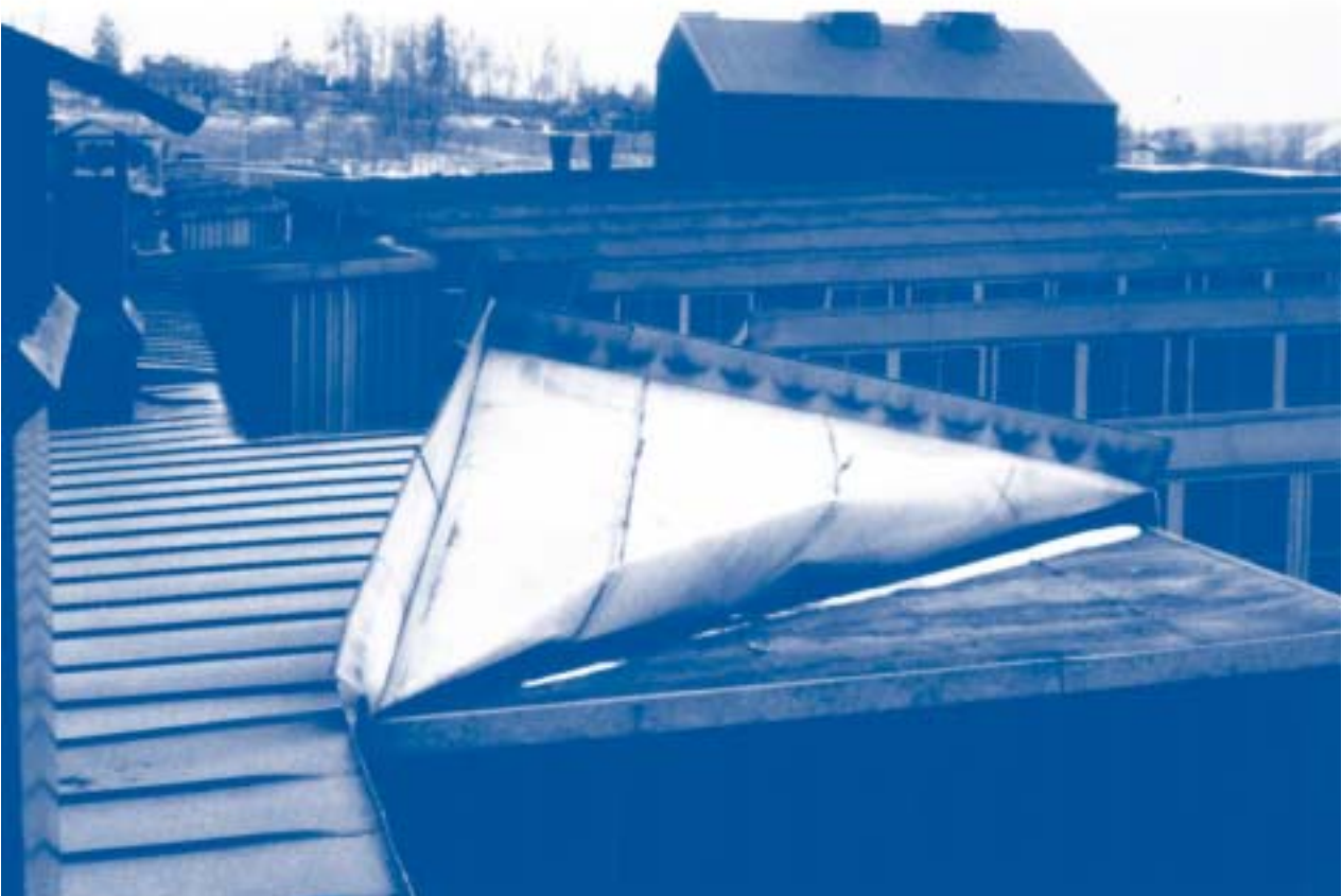
Hibásan rögzített síklemmezfedés szélszívás okozta tönkremenetele
